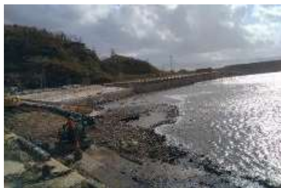
珠洲市大谷地区 海岸隆起状況
